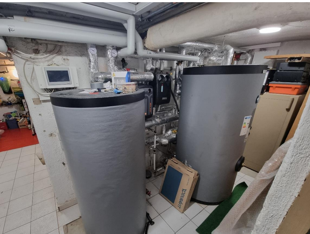
Hzg-Speicher (280l) + WW-Speicher (420l)
