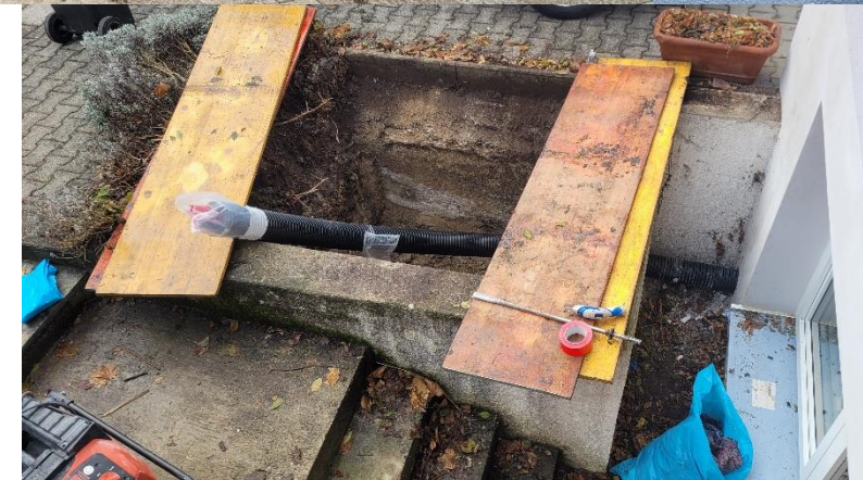
LWP-Anschluss ins Haus
